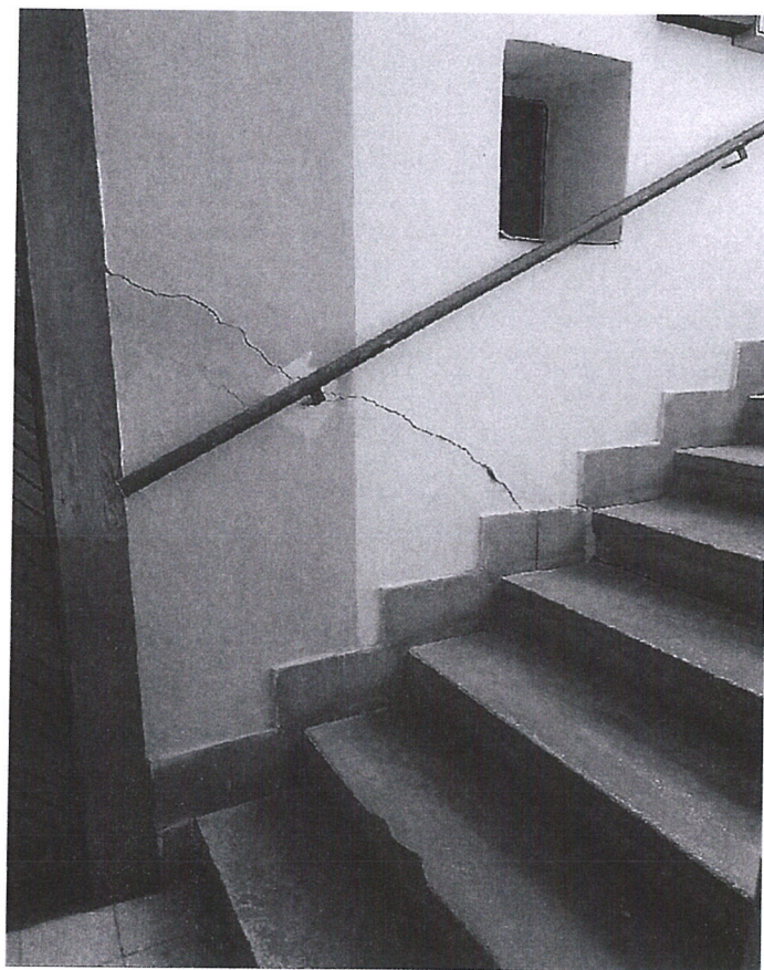
A 3. sz lakás melletti repedés.
