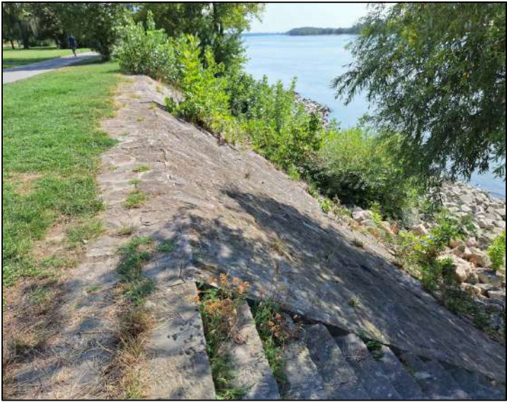
7. Ady Endre és József Attila sétány vízoldalán betonba rakott kőburkolatú részsű
