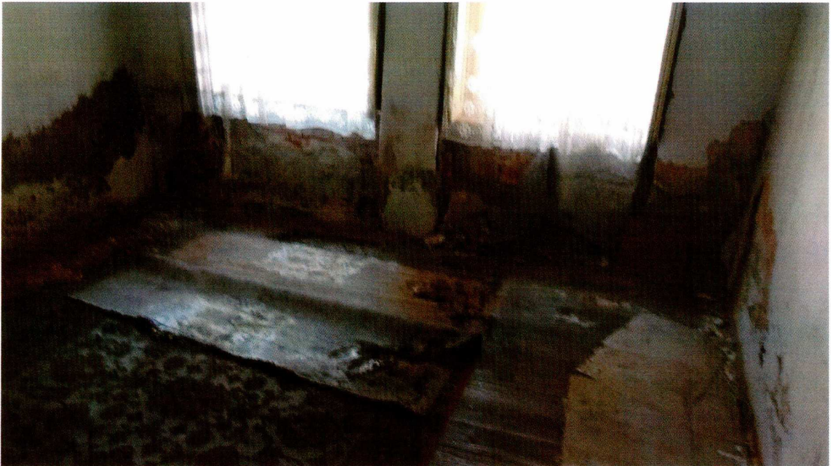
Belső helyiség – felázott, lemállott vakolattal, falakkal
