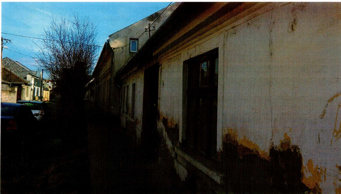
Utcai homlokzat – függőleges falrepedéssel
