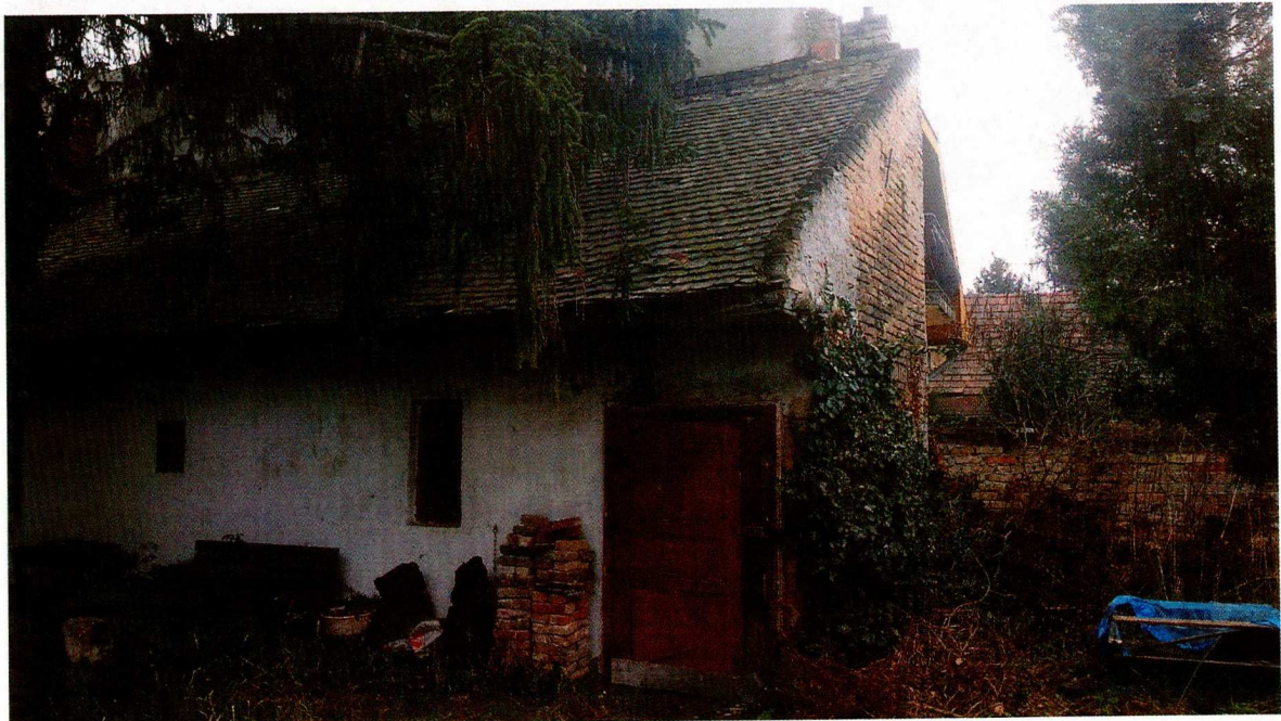
Udvari homlokzat – falrepedésekkel, megrogyott tetőszerkezettel
