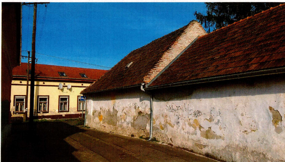
Utcai homlokzat – felázás nyomokkal
