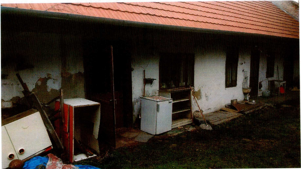
Udvari homlokzat – falrepedésekkel, felázásokkal
