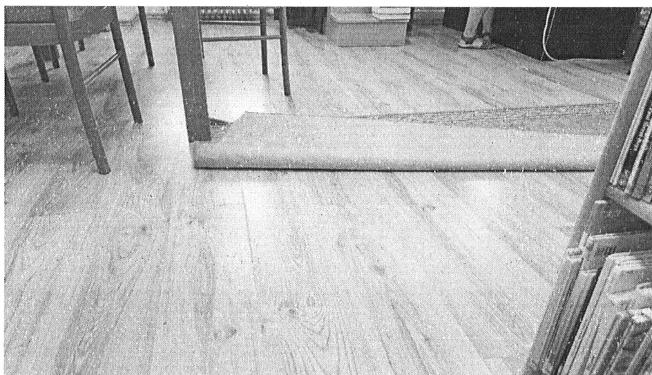
11. Gyermek könyvtár felázott, deformálódott padlóburkolat
